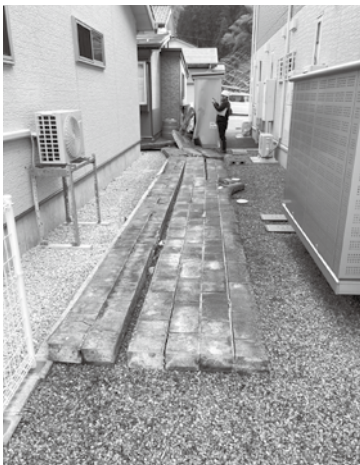
倒壊したブロック塀 (京ヶ峰)
